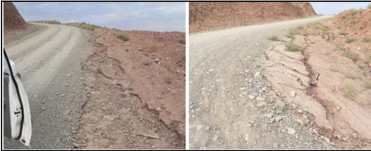
شکل شماره ۱۰ فرسایش شیاری و بعضاً آبکندی در شانه‌های راه ارلان
